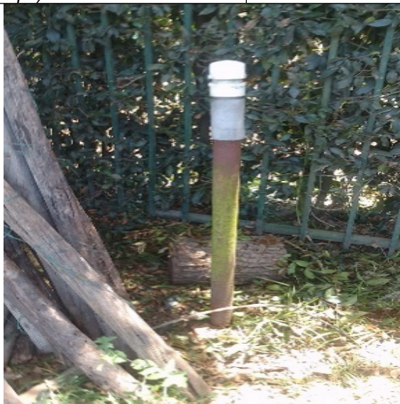
Foto No.3 Tubería del pozo pz-11-0220
